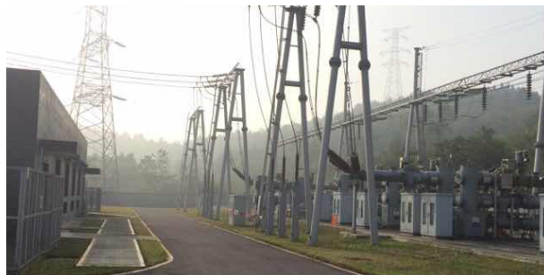
德阳寿封 220kV 变电站
