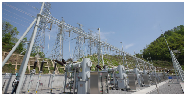
七里坪 220kV 智能化变电站
